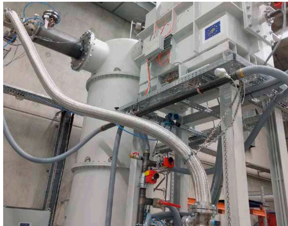
In der Pilotanlage wird der Speicher optimiert
